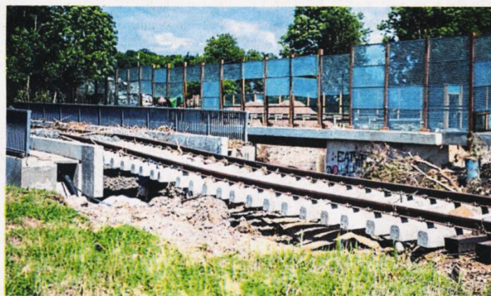
Die Gleise der Erfttalbahn zwischen Bad Münstereifel und Euskirchen wurden von den Wassermengen unterspült. Foto: Tom Steinicke
